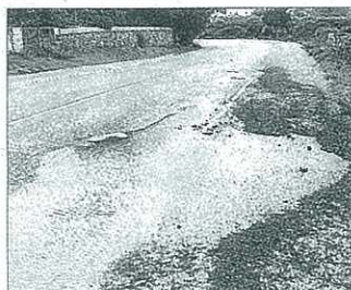
El acceso a Cala Blanca, en mal estado.
